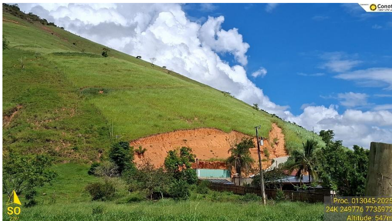
Figura 1: Vistoria técnica Consórcio Caparaó. Atividade: Terraplanagem (corte e aterro). Local: Muniz Freire – ES.
