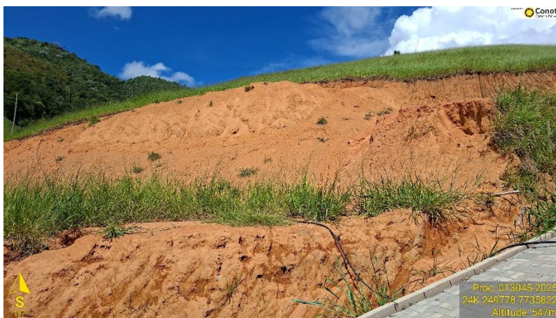
Figura 2: Vistoria técnica Consórcio Caparaó. Atividade: Terraplanagem (corte e aterro). Local: Muniz Freire – ES.
