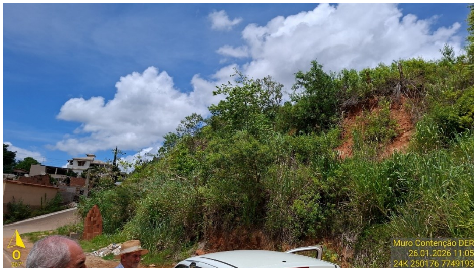
Figura 4: Vistoria técnica Consórcio Caparaó. Muro de Contenção as margens da ES-181.
