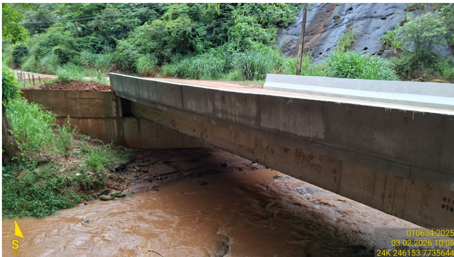
Figura 2: Vistoria técnica Consórcio Caparaó. Atividade: Construção de Ponte em rodovia ES 379. Zona Rural de Muniz Freire – ES.
