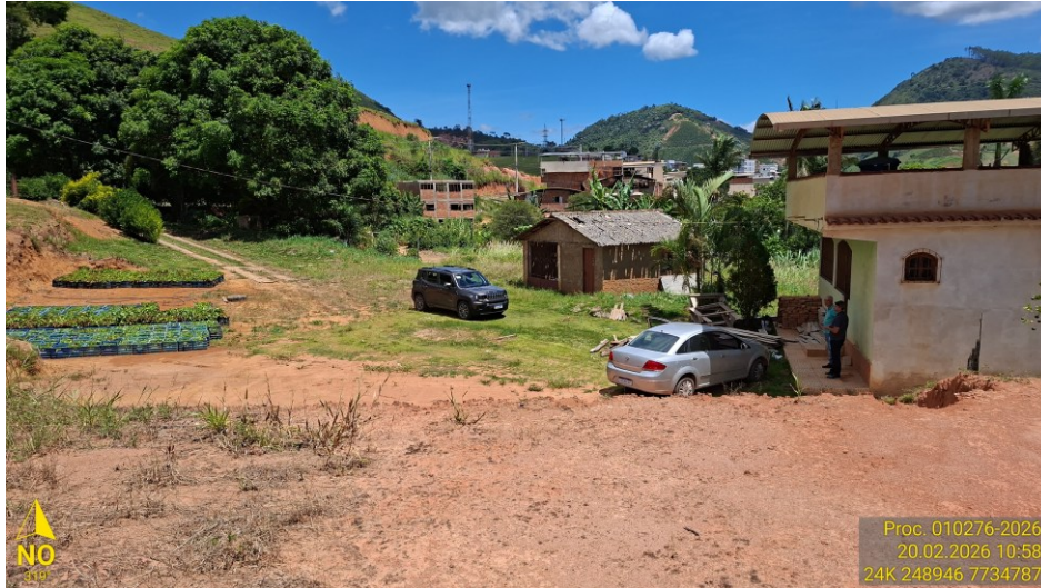
Figura 1: Vistoria técnica Consórcio Caparaó. Atividade: terraplanagem. Distrito de Alto Norte, Muniz Freire – ES.
